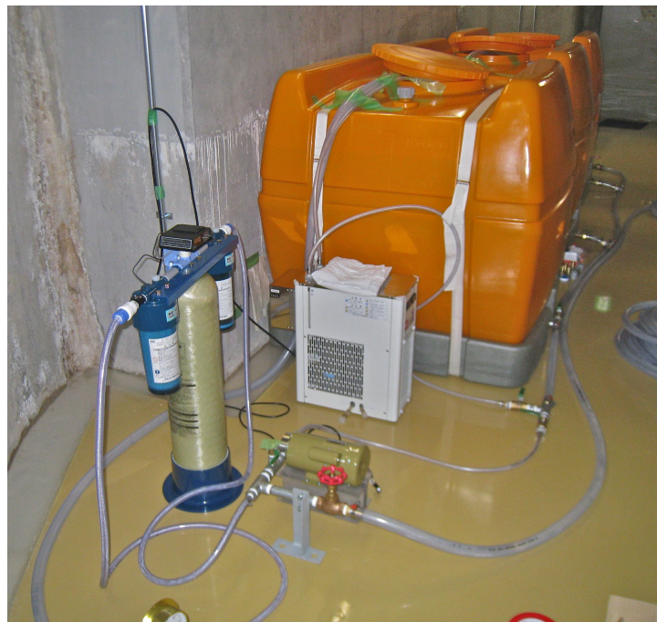
図 3.21: 使用するイオン交換樹脂 (手前) と橙色のバッファータンク (奥) の写真。
