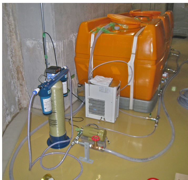
図 3.20: 使用するイオン交換樹脂 (手前) とバッファータンク (奥) の写真。
