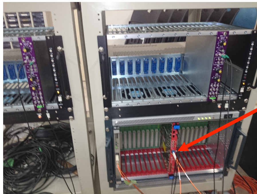
図12: Flash ADCの設置
